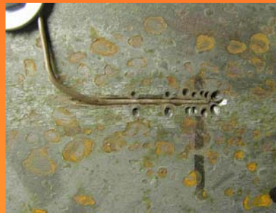
Temperaturmeßstelle am Stahlträger
