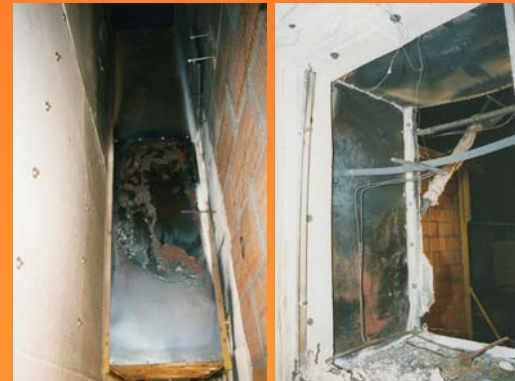
Zwischenfassadenbereich: links: Stahlabschottungen nach dem Brand intakt (Rauchdichtheit nicht überprüft), rechts: unteres Kastenfenster ohne Scheiben
