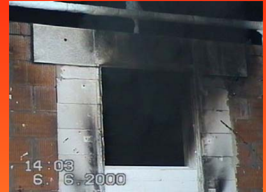
10 min 42 s (nach Zündung) an der Fensteröffnung
